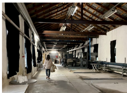
Notranjost kompresorske postaje
