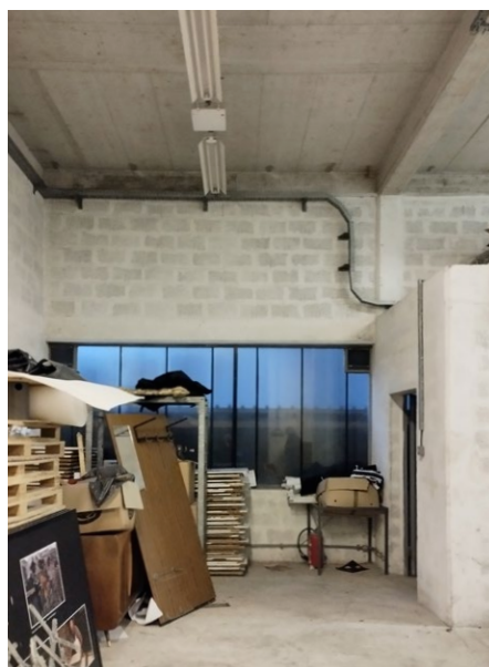
Notranjost nove transformatorske postaje
