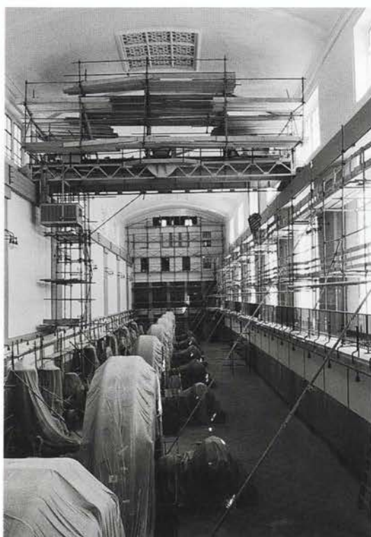
... »Po prenovi hidroelektrarne Fala 1996, so vse stare turbine in generatorje izločili iz obratovanja.« ...
